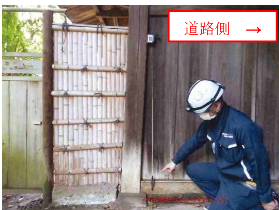
長屋門 門口内部の傾き
