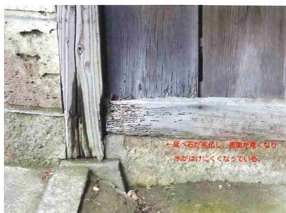
長屋門 門口内部の土台 （延べ石の劣化と木材の腐食部に蟻害）
