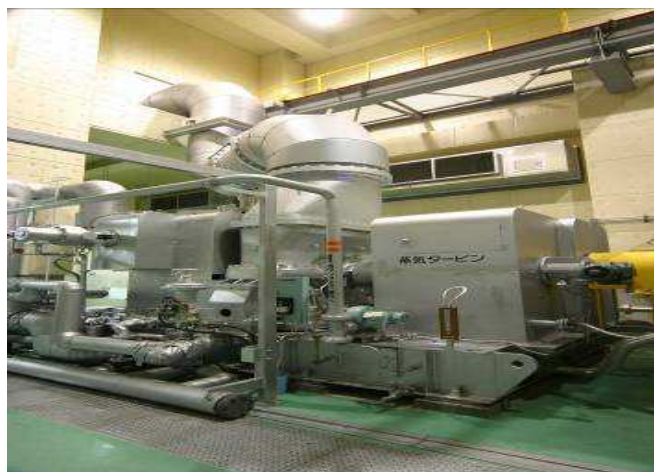
【蒸気タービン & 発電機】
