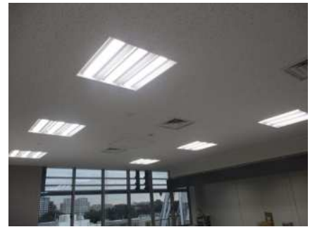
【市役所本庁舎に導入した LED 照明】
