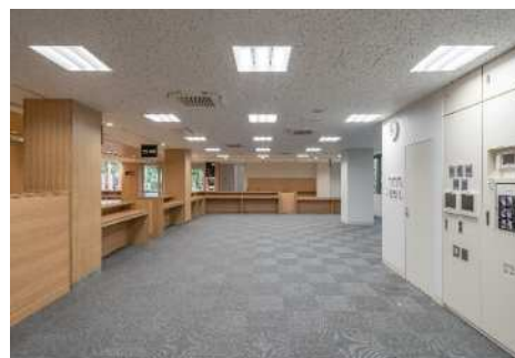
【辻堂市民センターに 導入した LED 照明】
