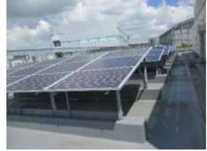
【藤沢市分庁舎に導入した太陽光発電システム（20 kW）】
