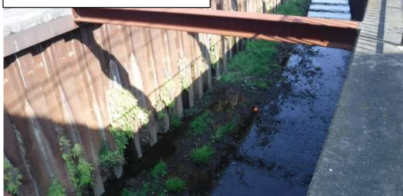
河床 土砂堆積
