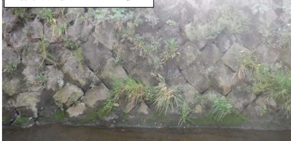
雑割石積 目地欠損
