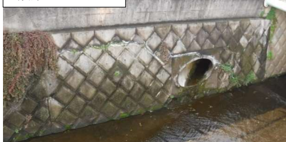
護岸 クラック
